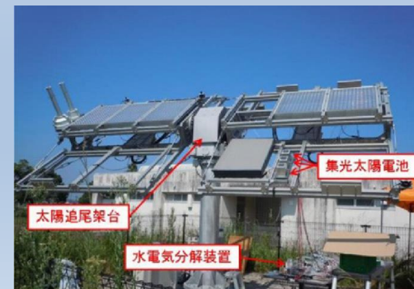
図2 富崎大学に設置した実験装置 出典：東京大学、富崎大学
